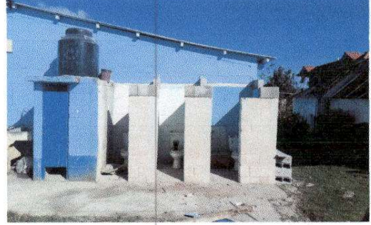
Foto 2: 4.3 Sustrucción de Puerta
